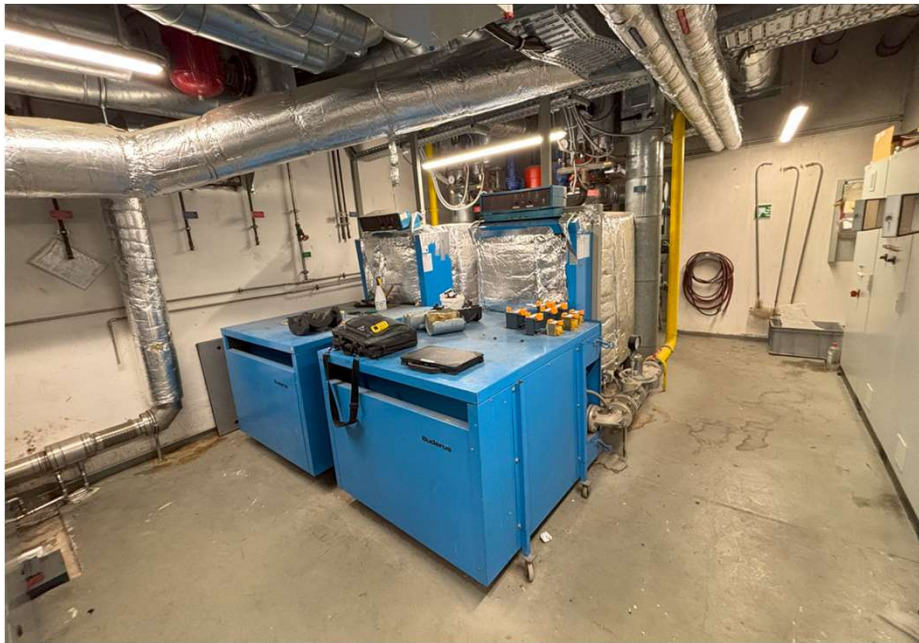
Gaskesselanlage (2 x 489 KW, Bj. 1989)
